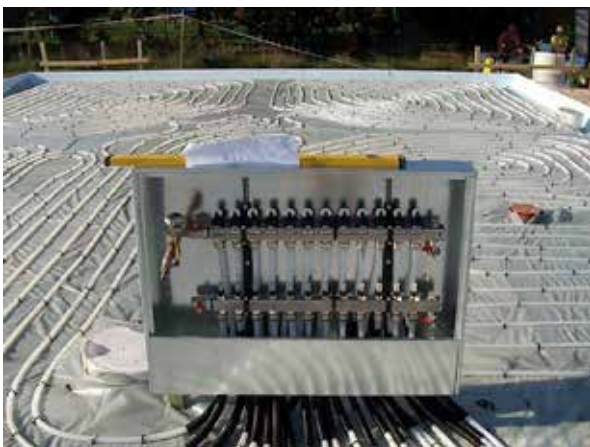
3. Flächenheizung und Heizkreisverteiler sind fertig.
